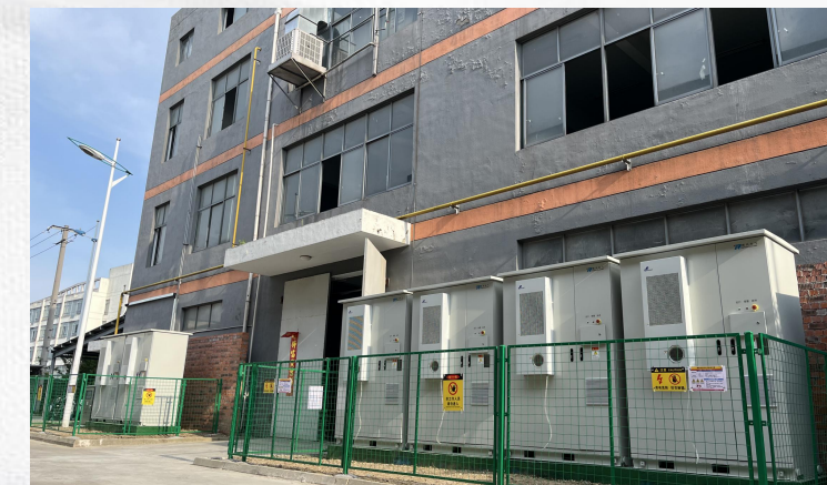
项目地点: 中国·苏州 项目配置: 储能标准柜 项目规模: 600kW/1.2MWh 项目进展: 成功验收
