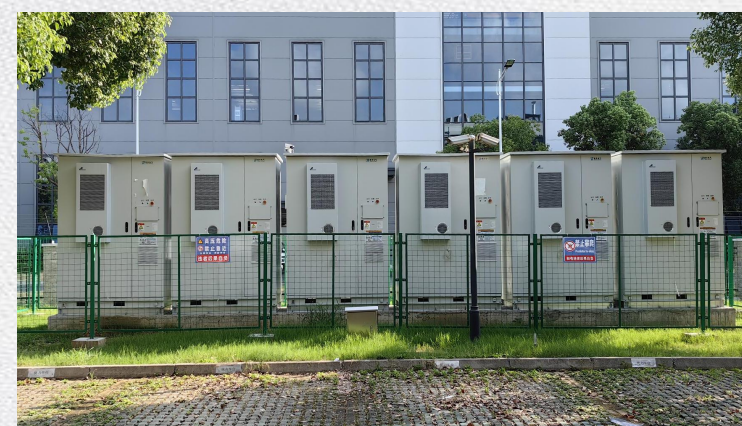
项目地点: 中国·苏州 项目配置: 储能集装箱项目 项目规模: 3.44MW/6.88MWh 项目进展: 成功验收
