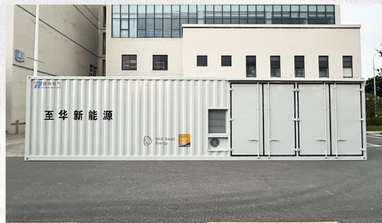
项目地点: 缅甸 项目配置: 标准储能柜 项目规模: 1MW/2MWh 项目进展: 成功验收
