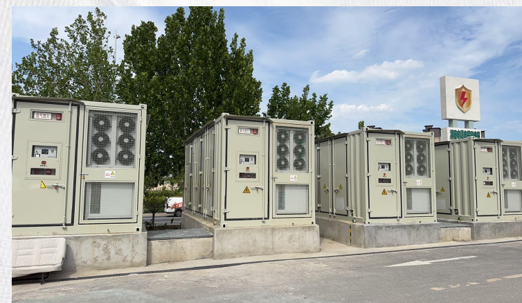
项目地点: 中国·河南 项目配置: 储能集装箱项目 项目规模: 6.9MW/11MWh 项目进展: 成功验收
