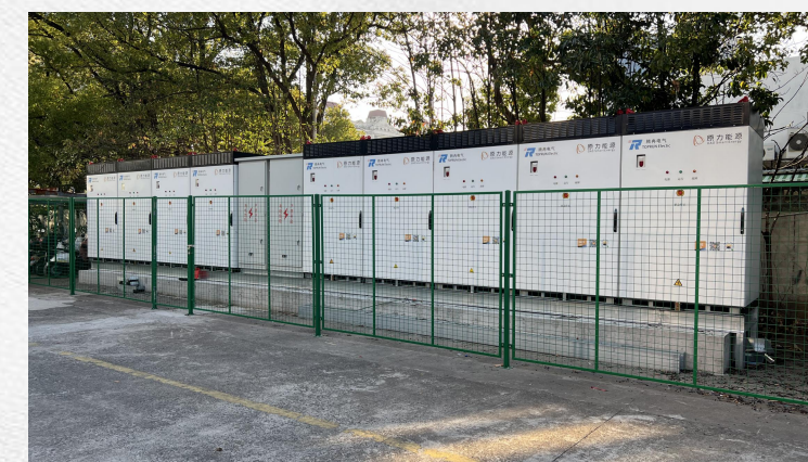
项目地点: 中国·上海 项目配置: 储能电站项目 项目规模: 3MW/6.45MWh 项目进展: 成功验收
