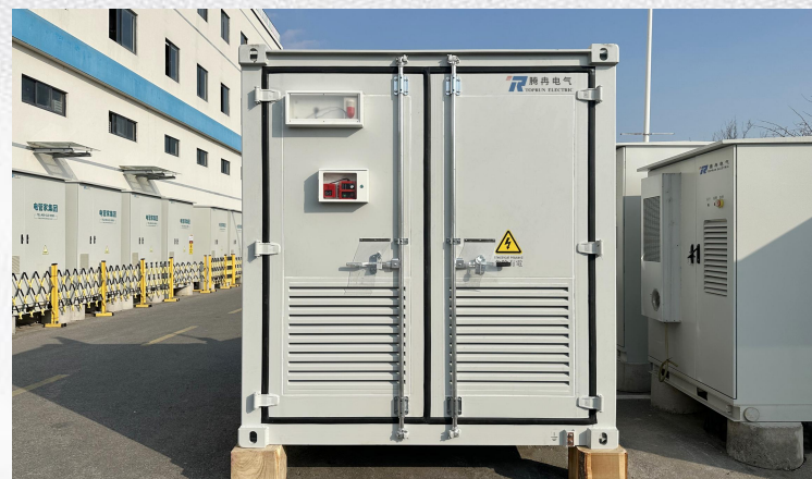
项目地点: 中国·香港 项目配置: 储能集装箱项目 项目规模: 372kW/372kWh 项目进展: 成功验收
